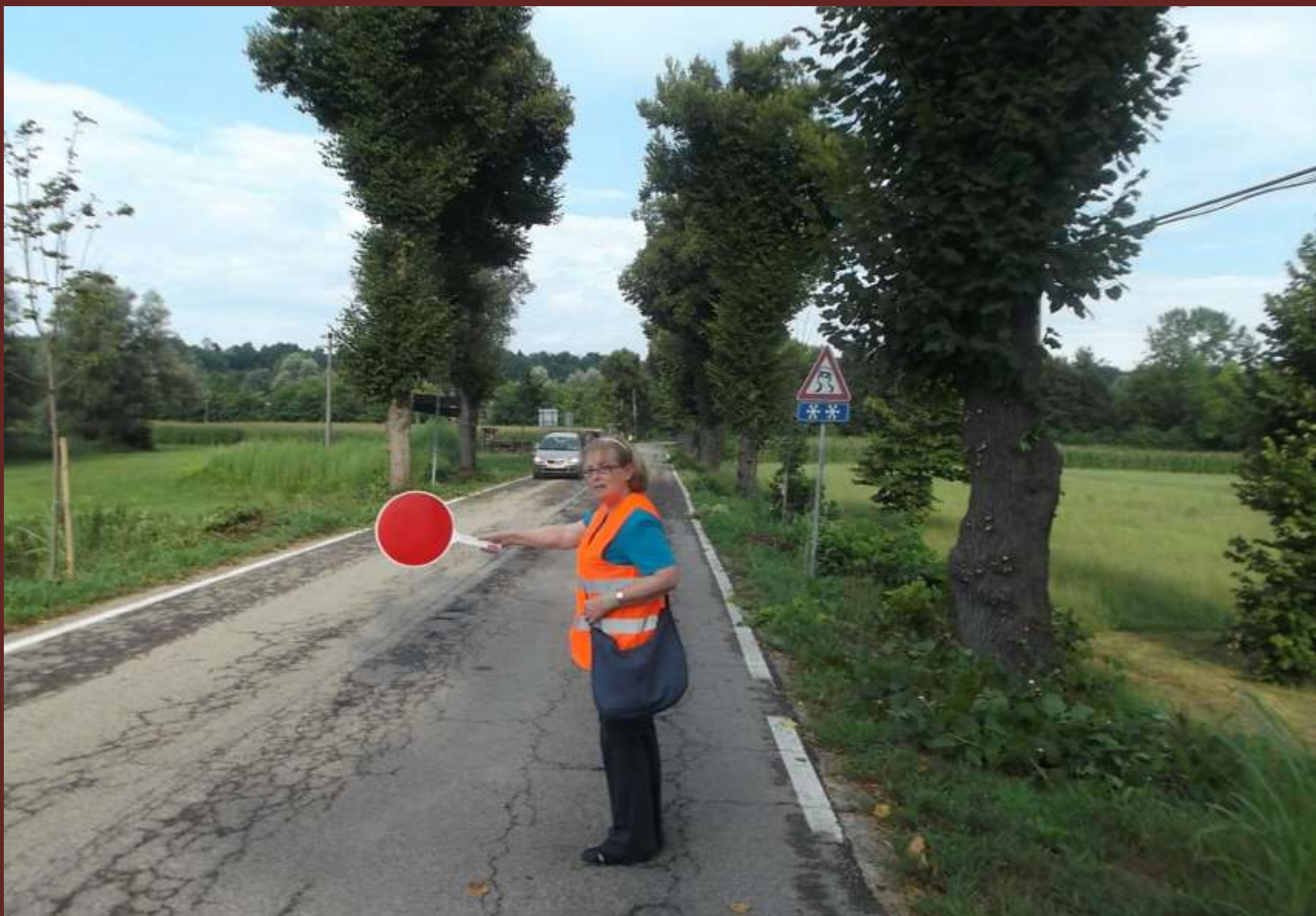
Regolazione del traffico alternato per la gestione in sicurezza del Cantiere stradale di spollonatura
