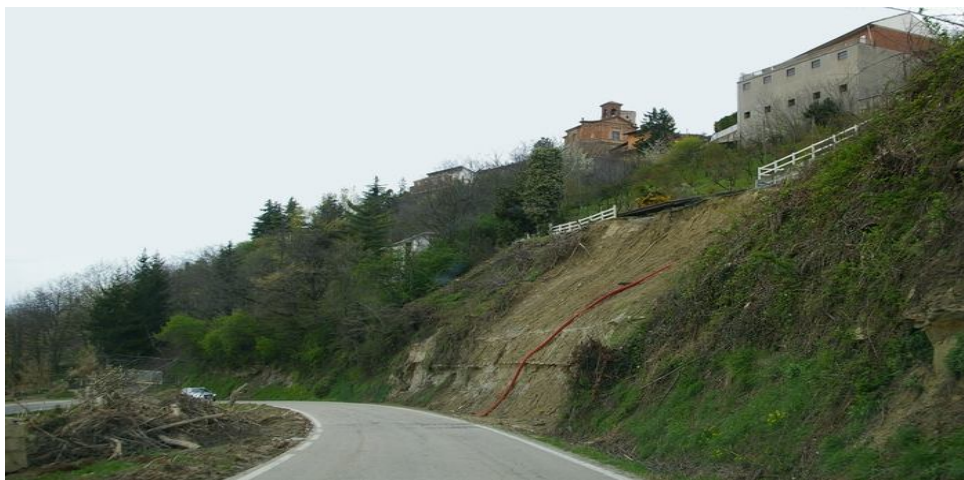
Frane presenti lungo le strade dell'Astigiano
